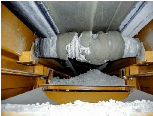
Ambiente sucio, material impregnado.
